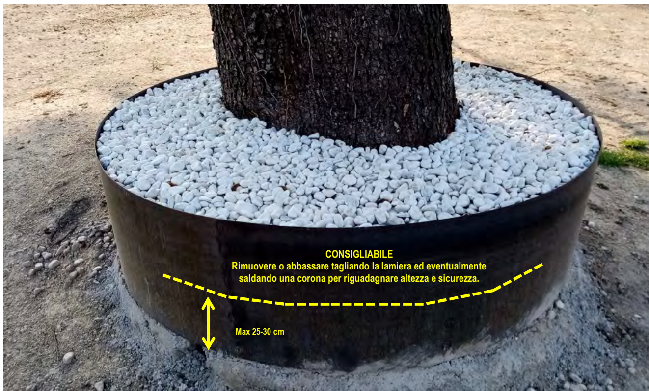
STRUTTURE ALLA BASE DEGLI ALBERI: favoriscono condizioni di marciume al piede
