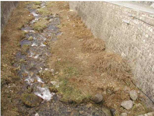
La bonifica totale della vegetazione ripariale espone il collettore al rischio di ricolonizzazione massiva di vegetazione esotica
